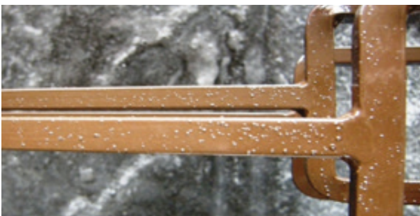
Abb. 1 | Duplex-beschichtetes Geländer mit Pusteln
